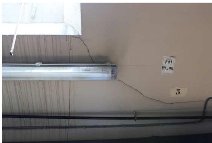
Dépôt Louis-Philippe, 2 e étage, salles 205-206 : dégradations près des vasistas
