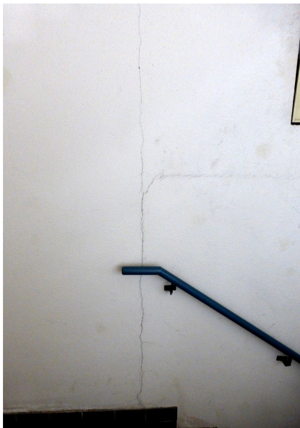
Le bâti se lézarde et se fissure...
